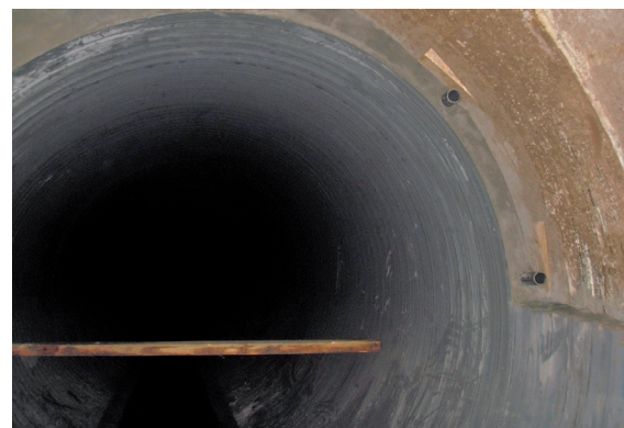
Канализационная шахта с установленной в ней подпоркой для дальнейшего процесса заполнения межтрубного пространства
